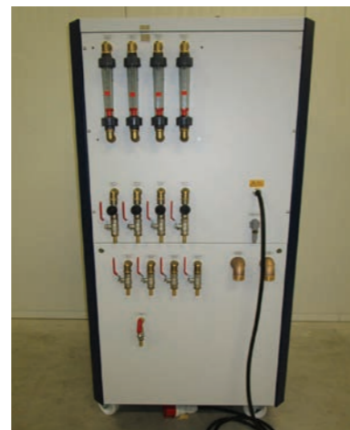
Laborkühler mit Mehrfachverteiler am Gerät
