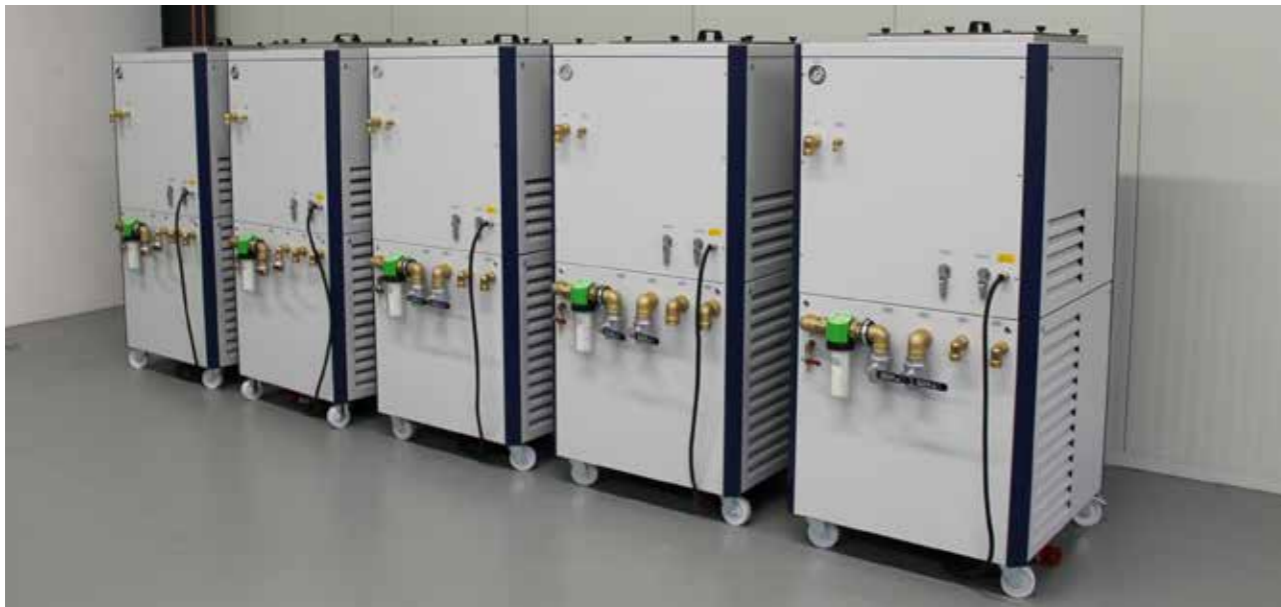
80 kW Systemtrenner mit Filter auf der Sekundärseite
