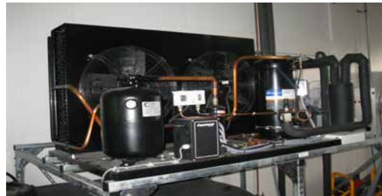
Wärmerückgewinnung im Prüfraum
