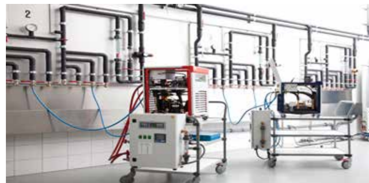
Unser Prüfraum für Systemtrenner und WG-Anlagen
